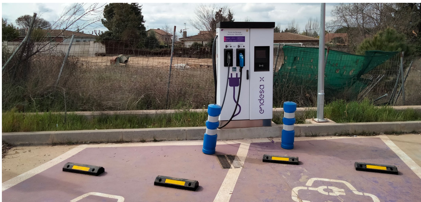
Figura 4.5.2. Imagen de un punto de carga, situado en una gasolinera. Dos plazas de aparcamiento para acceder a dos conectores de 50 kW y uno de 25 kW. La citada gasolinera dispone de 8 surtidores de combustible.
